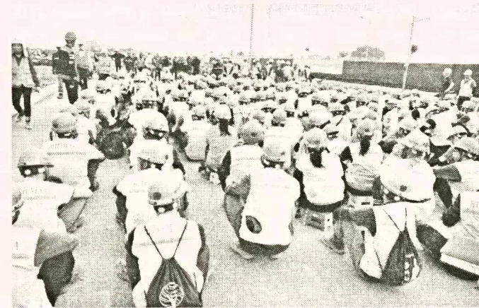
Công nhân Công ty Hoa Nghĩa trên công trường thi công dự án nhà máy ở Bắc Ninh năm 2023, dưới vai trò thầu phụ cho Hitech Vina. Ảnh: VĂN TRƯỜNG
