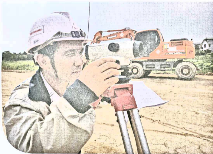
Cán bộ kỹ thuật Công ty CP Xây dựng và Thương mại Phượng Hoàng làm việc tại đường Vành đai 4, đoạn qua thị xã Thuận Thành, Bắc Ninh
