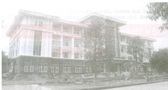
Đơn vị thi công đang sơn màu khối nhà làm việc chính của dự án trụ sở các Ban Đảng tỉnh
